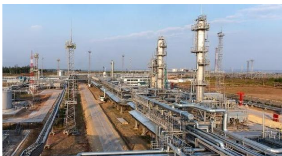
Компрессорные установки Ярактинское НГКМ
